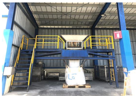
Khu vực máy đập thủy tinh
