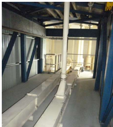
Hệ thống ống hút bụi tải malt từ silo
