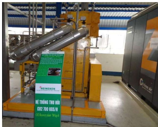
Hệ thống thu hồi CO 2 700kg/h
