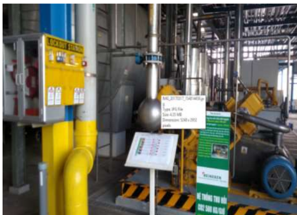
Hệ thống thu hồi CO 2 500kg/h
