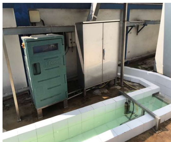
Trạm quan trắc nước thải tự động
