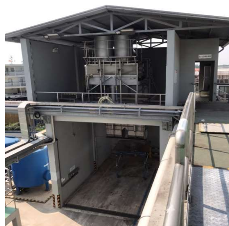
Nhà chứa máy ép bùn
