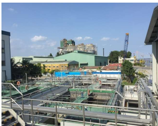
Hệ thống xử lý nước thải hiện hữu
