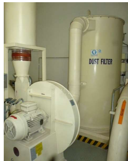
Hệ thống tách bụi tải gạo từ silo đến máy nghiền
