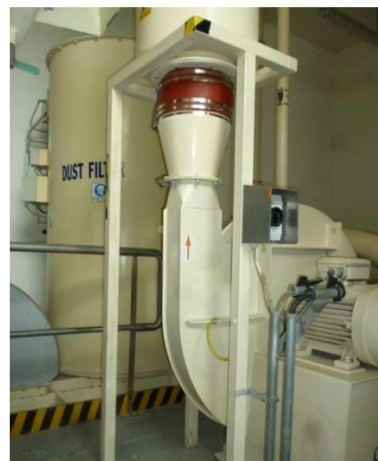
Hệ thống hút bụi tải bột gạo từ máy nghiền đến bồn chứa bột gạo
